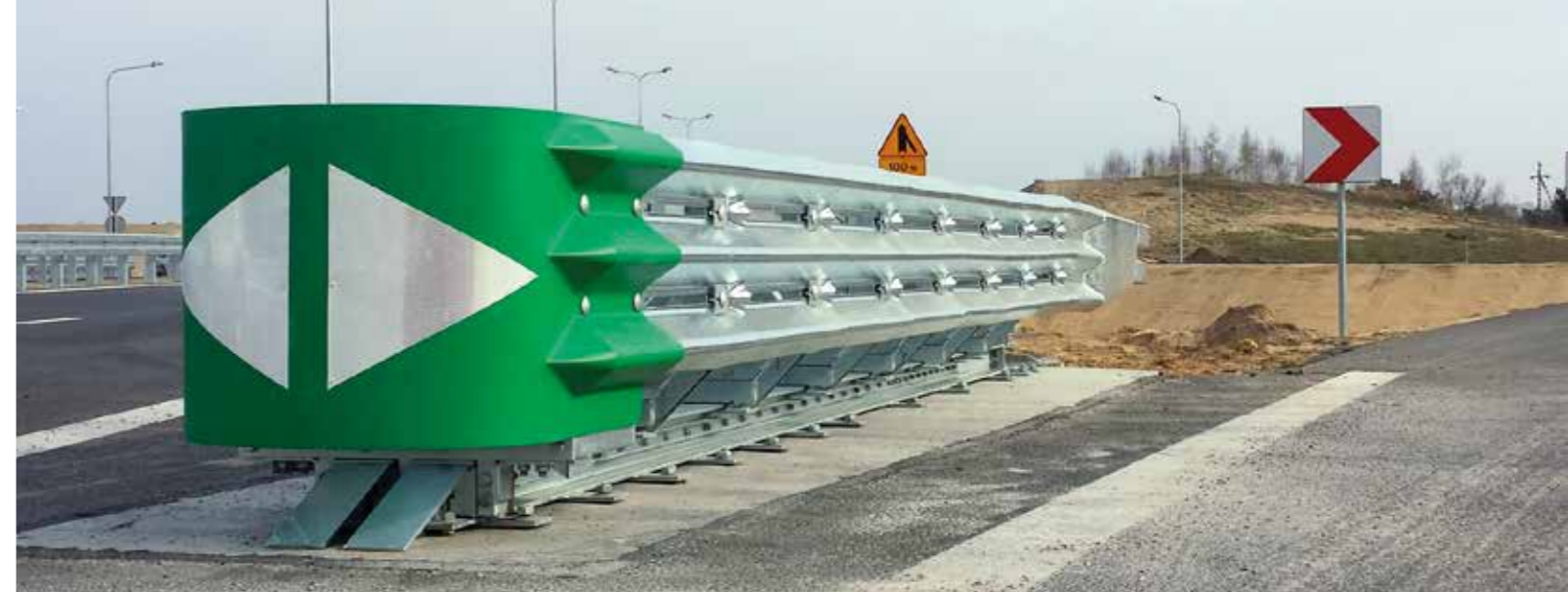
System Hiasa Air-H100P, realizacja na drodze S3 Międzyrzecz- Gorzów Wlkp.
