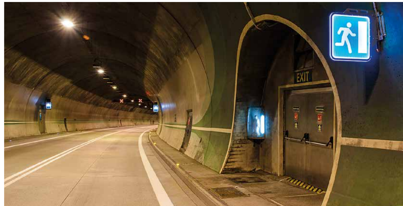
Podświetlane oznakowanie wyjścia ewakuacyjnego z tunelu na Słowacji.
